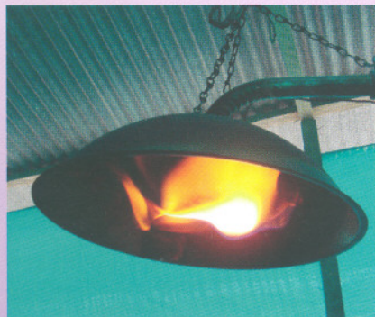
Criadora en mal estado
